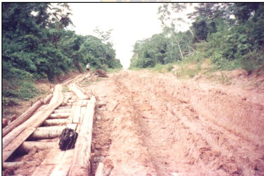
Figura 15. Carretera Marginal de la Selva en 1993, completamente intransitable en la temporada de lluvias
